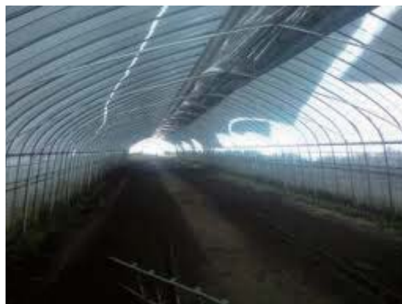
写真 34 無加温ハウスで、ハウス密閉により屋根面の雪が滑落している状況
