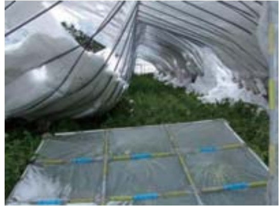
写真46 倒壊したハウスの状況 (内側)
