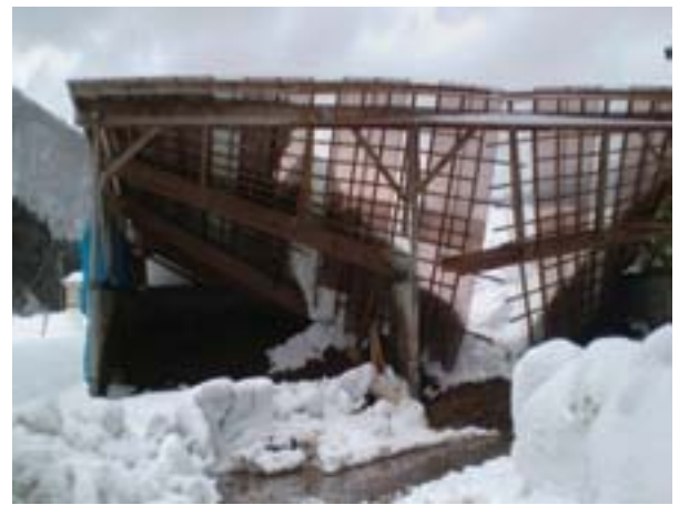
写真 38 堆肥舎屋根の損壊状況
