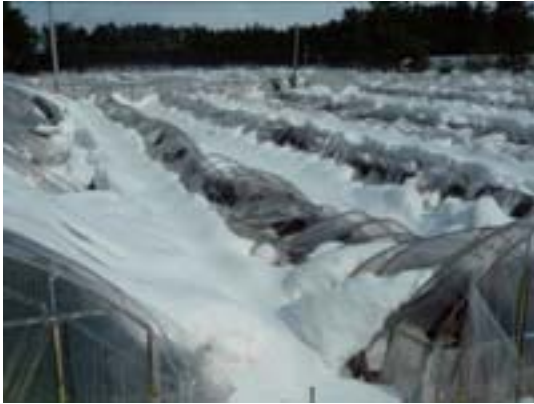
写真45 倒壊したハウスの状況 (外側)
