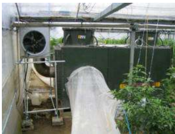
写真5 廃熱回収装置の設置状況
