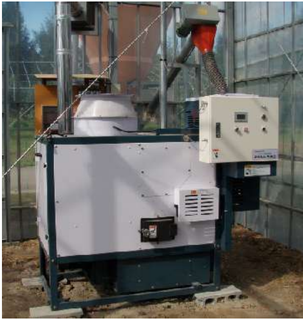
写真1 ハウスおとうでのペレット暖房機利用
