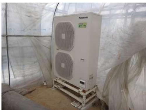
導入したヒートポンプ
