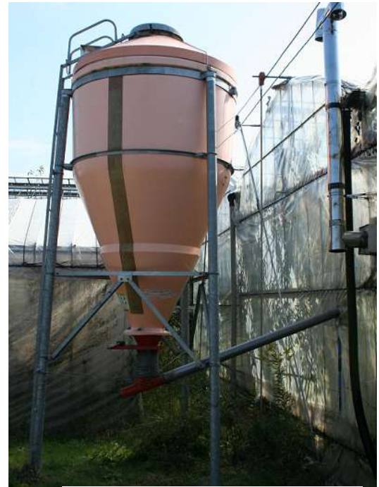
写真2 ペレットタンク
