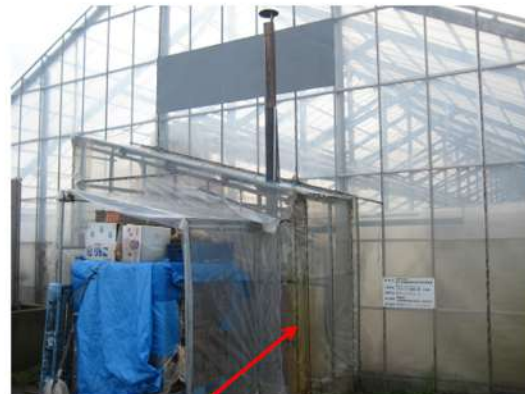
ボイラーの設置外観
