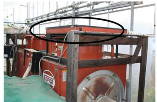
○印がヒートポンプ
