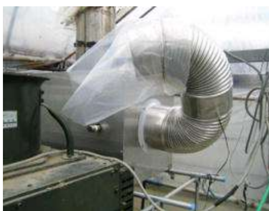
写真6 廃熱回収装置の排気口
