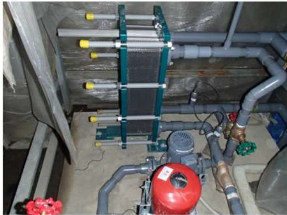
くみ上げた井戸水との熱交換を行うプレート式熱交換器
