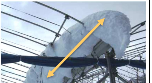
雨樋の雪は多くなる前か、硬くなる前に下ろす
