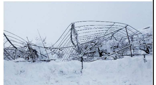
大雪によるハウスの倒壊
